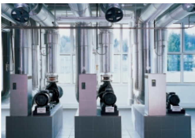
Котловые циркуляционные насосы с частотным регулированием
