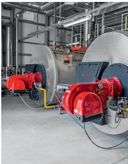
Паровой котел с двумя газовыми горелками WM-G30 в исполнении multiflam® с частотным управлением – общая мощность 9 МВт
